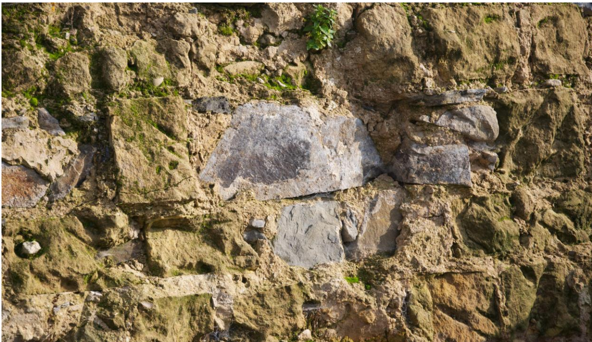
Afbeelding 5.2: Restanten van de weggebroken mergelbeklamping van de ringmuur, waardoor op sommige plaatsen de hardsteen van de vulling weer zichtbaar is.
