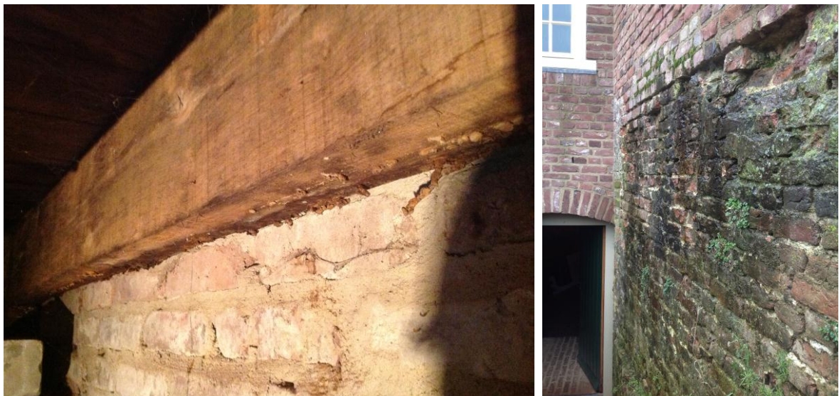
Afbeelding 1.1: Vochtproblematiek in het gerestaureerde Jachtslot: schimmelvorming op de balken in de keukenruimte (links) en doorsijpelend water door het oude muurwerk.
