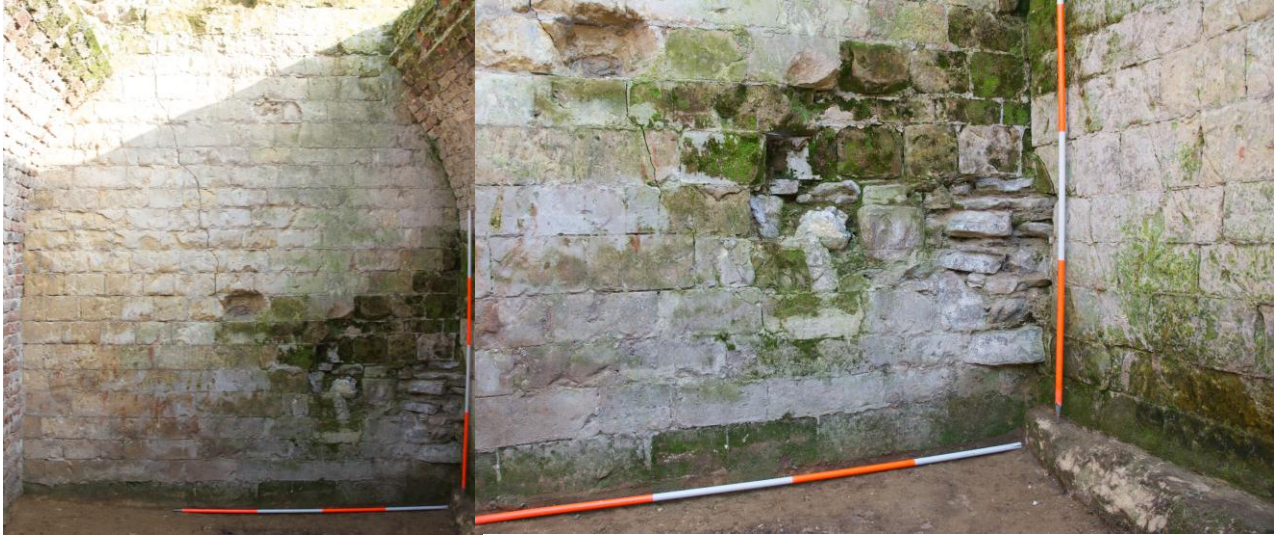
Afbeelding 4.10: Opname van de achterwand van steekkelder B, met daarin zichtbaar grote scheuren, die in 1779 al door rentmeester Michiels werden gemeld.
